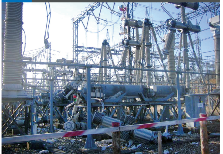
写真 1 1000 ガル以上の地震動に襲われた新福島変電所
