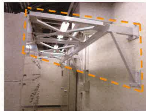
直流電源装置 (対策後)
