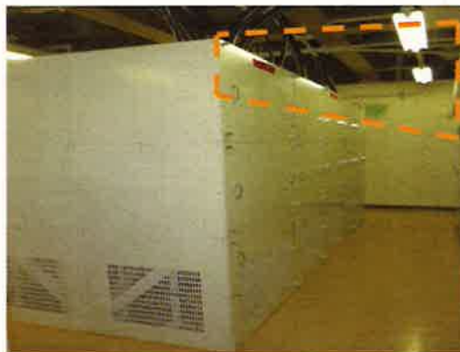
直流電源装置 (対策前)
