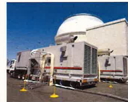
空冷式非常用発電装置
