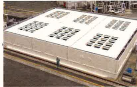
海水ピットポンプ室（飛来物対策後）
