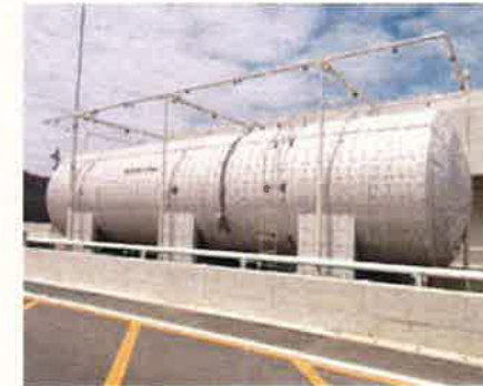
重油タンク（非常用DG用）
